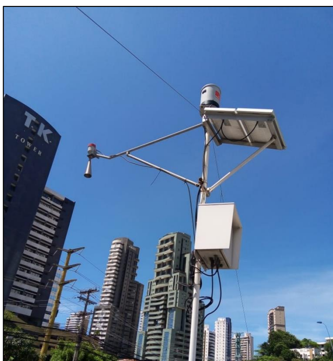
Figura 56 - Exemplo Estação Hidrológica Online - Pluviômetros e Sensor de Nível de Canal de Macrodrenagem
