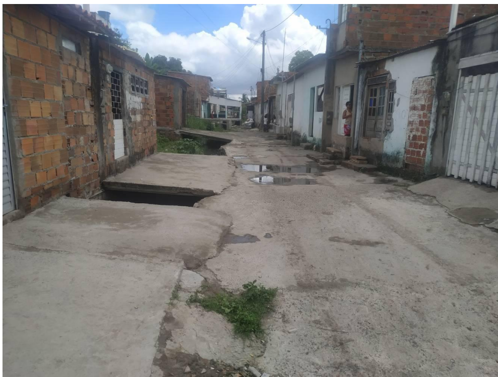
Figura 13 - Trecho precário ao longo de edificações
